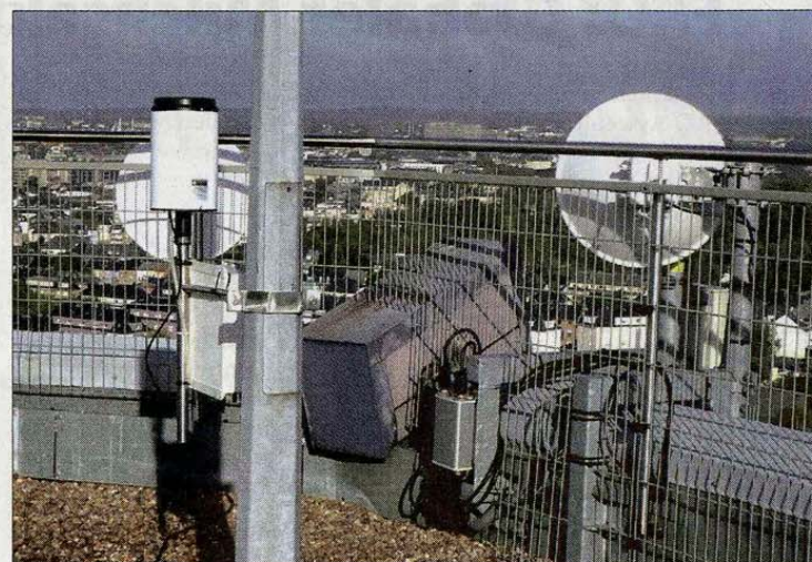
Antenne de télécommunication et pluviographe au sommet du château d'eau de Kaltreis.
